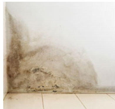
Fig. 12 – Mucegai pe un perete cu umezeală crescută
