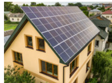
Fig. 10 – Panouri solare pe acoperișul unei locuințe
